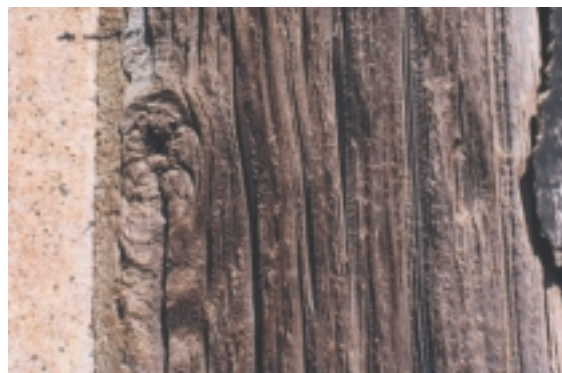
圖 6. 彰化益源古厝大門福州杉柱材表面開裂
