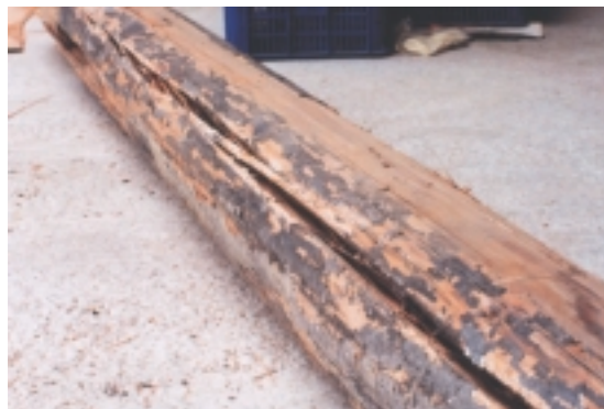
圖 5. 霧峰林宅宮保第福州杉柱材表面裂縫
