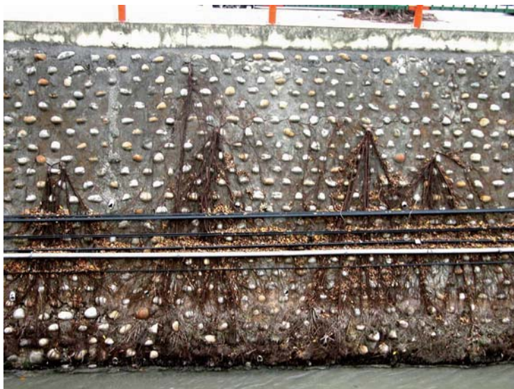
圖 7. 根系從水道之坡面鑽出，在壁面蔓生
