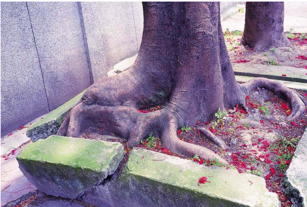
圖 5. 鳳凰木形成之粗大板根將大型植栽槽崩裂
